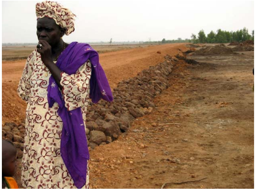
Ein Steinwall gegen Überschwemmungen.
